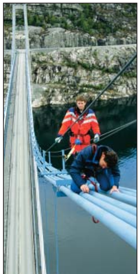
Etter siste inspeksjon før ferien er det registrert tilsaman 609 kabelbrot på Lysefjordbrua. (Arkivfoto: Geir Brekke)
